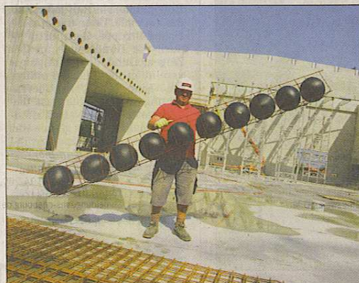
Oberpoller Josef Stern von der Firma Moser zeigt eines der Bauelemente mit Plastikugeln, die das neue Dach leichter machen.
